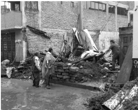
Figura 50. Vivienda afectada totalmente. 2014. Foto: Juan Carlos Velasco.
