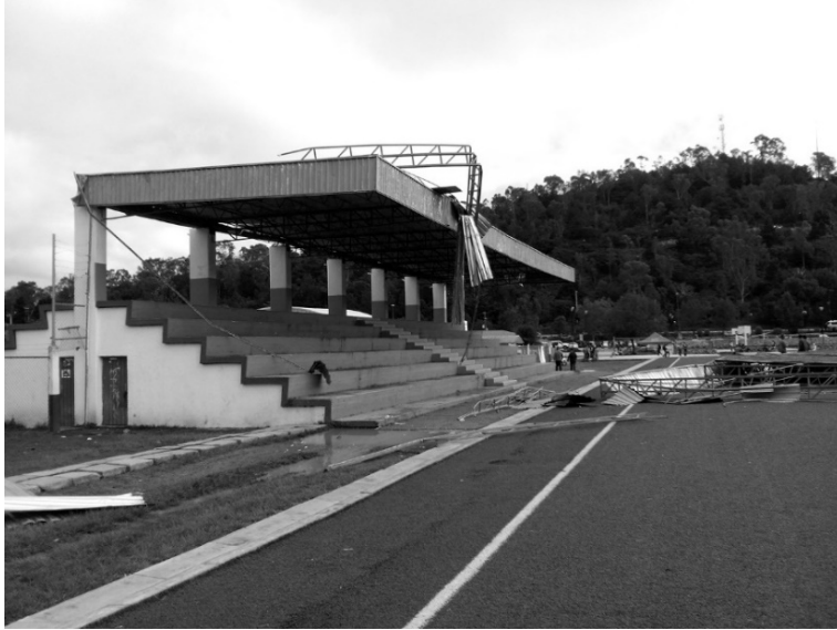
Figura 46. Techo desprendido del campo de futbol. SEDEM. Foto: Juan Carlos Velasco.
