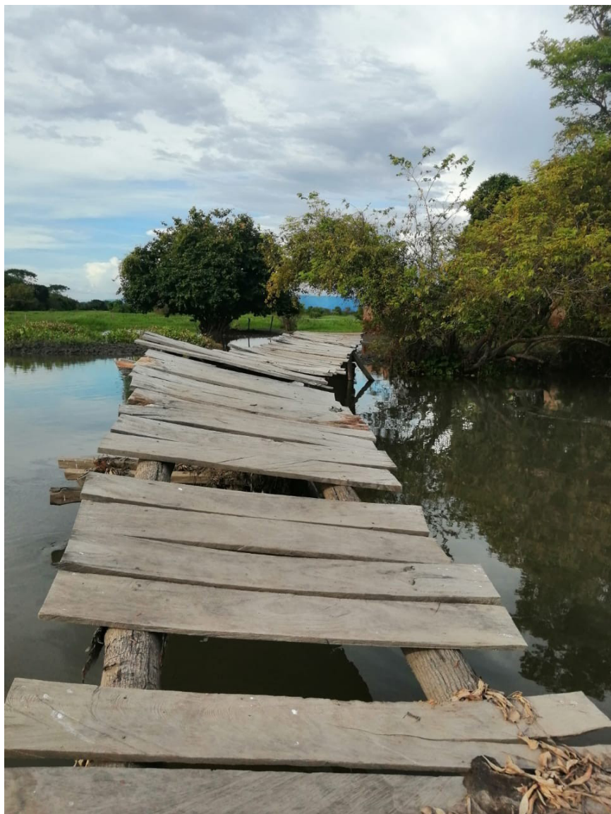
Figura 144. Estado del puente vereda Mateguadua, zona urbana 63
