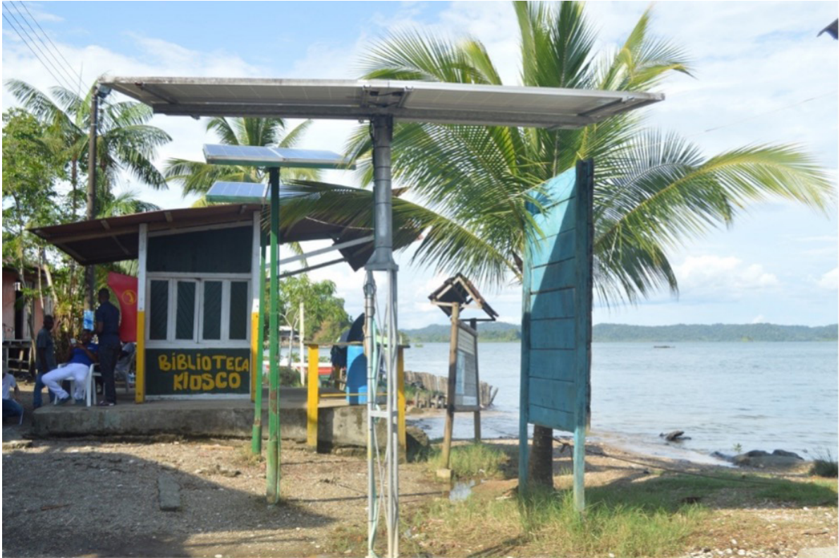
Figura 35 Sistema solar individual. Restaurante o cocina comunitaria en La Plata, Bahía Málaga
