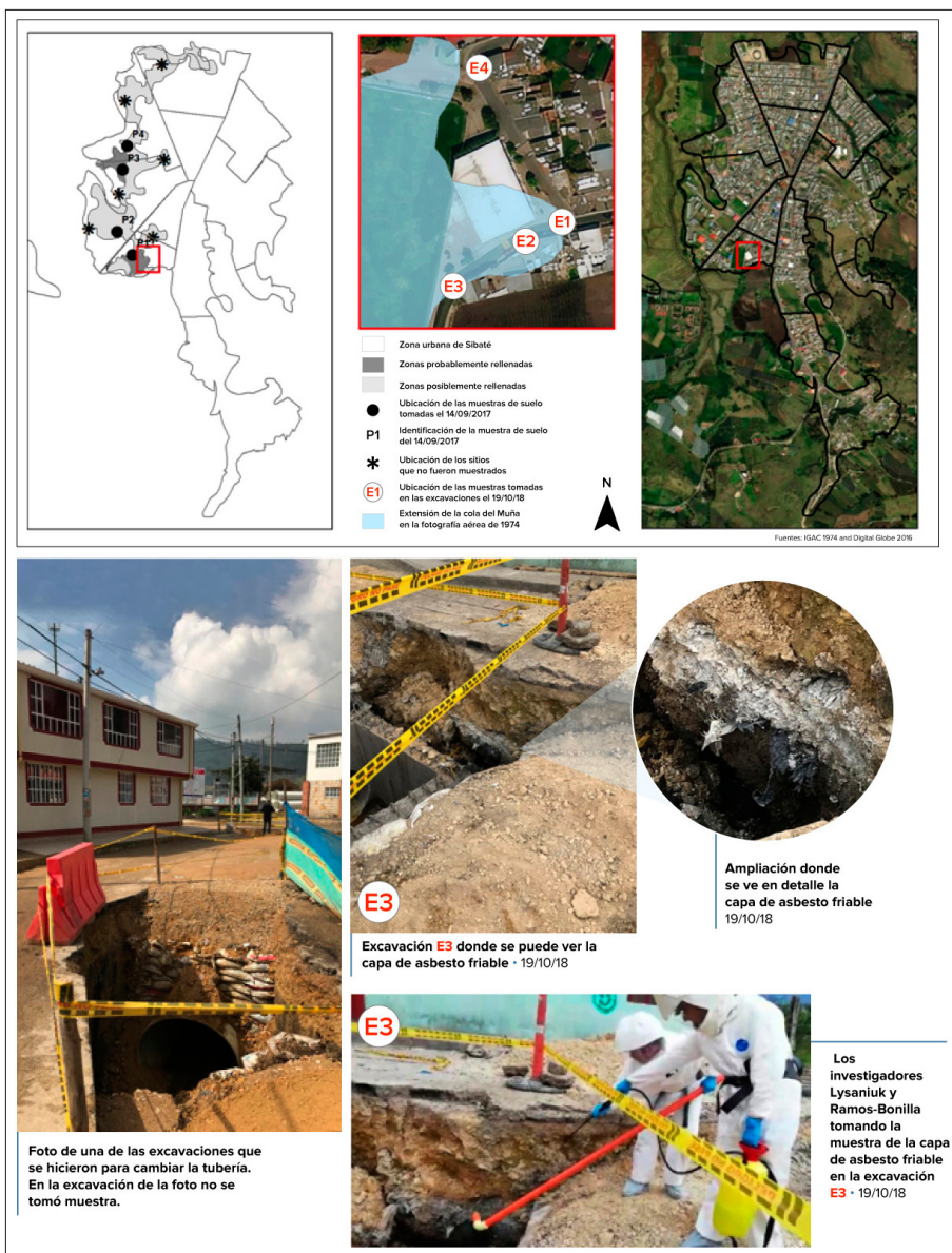
FIGURA 6. Ubicación de las muestras tomadas el 18 de octubre del 2018. Muestras extraídas de las excavaciones hechas por el municipio (E1 a E4) y en ellas se puede apreciar en detalle la capa de asbesto friable y el proceso de toma de una muestra.
