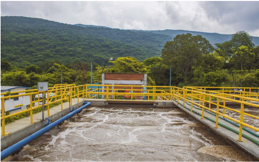
Figura 14. Planta de tratamiento de aguas residuales de Jalpan de Serra. Allí se trata el agua de esa localidad urbana, incluyendo las aguas negras y grises de las casas, así como las escorrentías de las calles. Además, el agua limpia de un manantial debajo de Jalpan se dirige a la corriente de aguas residuales. Como resultado, el sistema a menudo excede su capacidad en términos de volúmenes de agua, particularmente durante la temporada de lluvias, y luego no es capaz de limpiar el agua con la calidad deseable antes de descargarla en el río Jalpan. Créditos de Cristian Eduardo Rodríguez Jacinto
