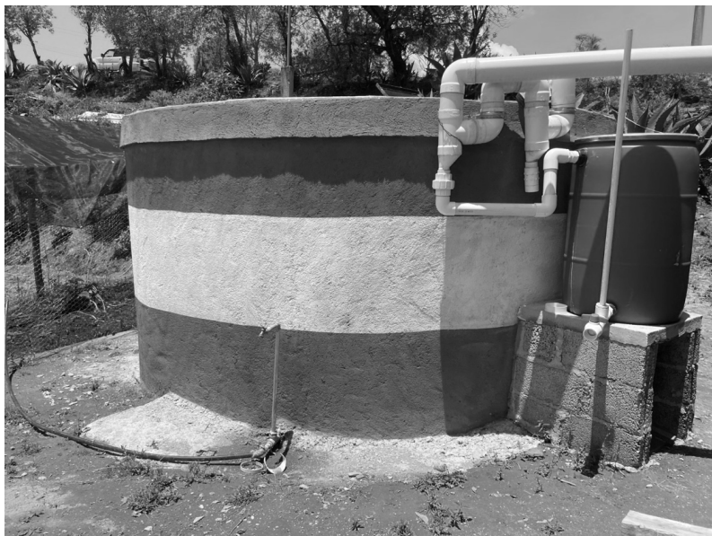
Figura 3. «Sistema de captación pluvial rural». Ejemplo de SBN. Fuente: Fotografía tomada por el autor en noviembre de 2024.
